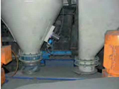
Abreinigen von festen Anbackungen mit Druckluft-Kolbenvibratoren
