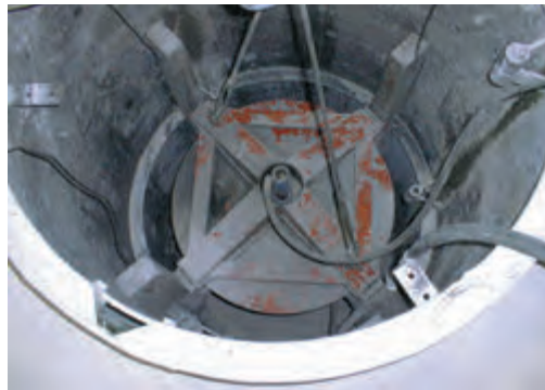
Ofenzustellung mit NKH
